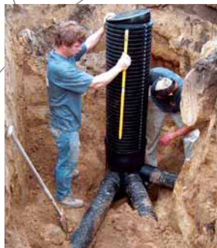
Schacht met 3 horizontaal verzette buizen
